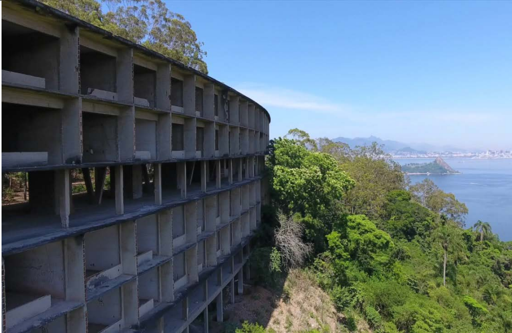
Figura 6: Vista mais aproximada da estrutura inacabada e abandonada do PBH e, ao fundo, o horizonte deslumbrante do Rio de Janeiro, 2016.
